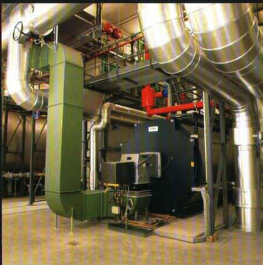
Chaudière à gaz
