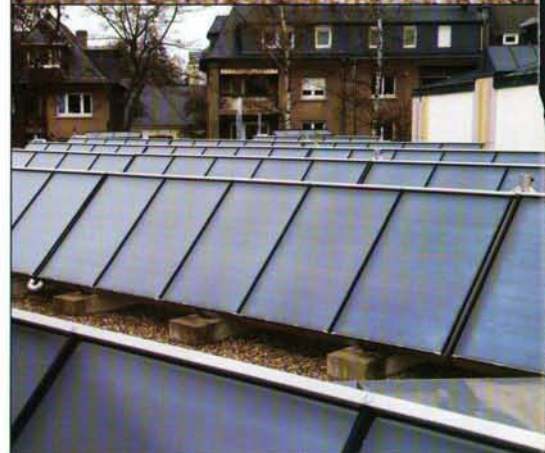
Panneaux solaires Ecole Batty Weber
