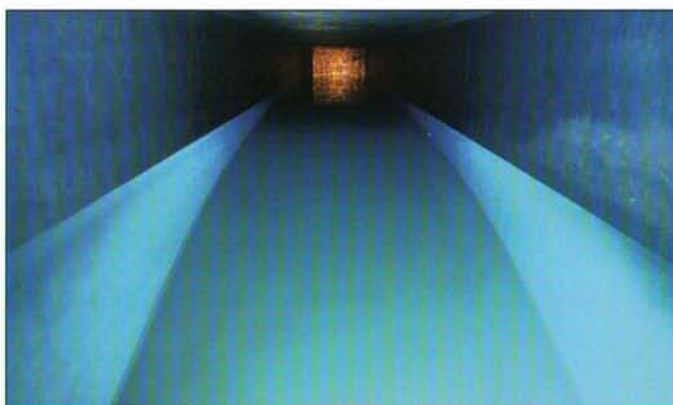
Eine von zwei Wasserkammern im Behälter Bridel Fassungsvermögen: 2 x 3 750 m 3
