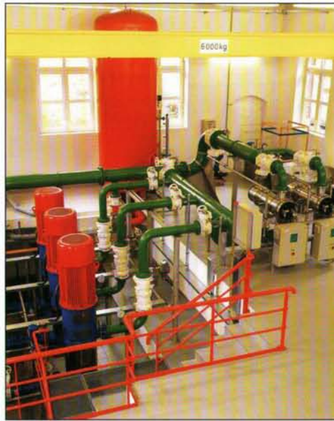
Vollautomatische Pump- und Filteranlage in Kopstal, die im Jahre 2000 fertiggestellt wurde
