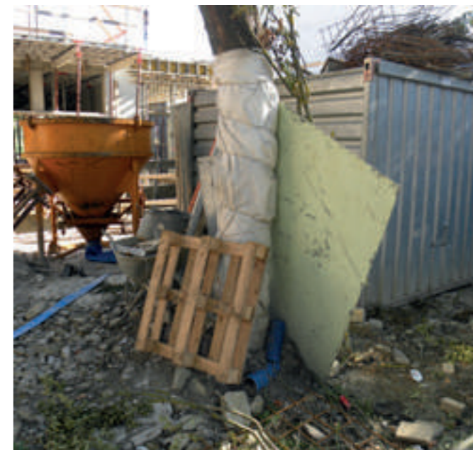
On a essayé de mettre en place une protection du tronc. Cependant, l'environnement des racines n'a pas été pris en compte et, contrairement aux recommandations, des matériaux de construction ont été entreposés près de l'arbre.
