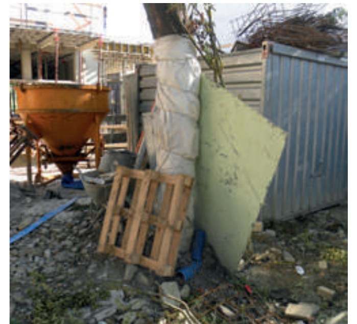
Es wurde versucht, einen Stammschutz aufzustellen. Dabei wurde allerdings keine Rücksicht auf das Wurzelumfeld genommen, und entgegen den Empfehlungen wurden Baumaterialien am Baum gelagert.
