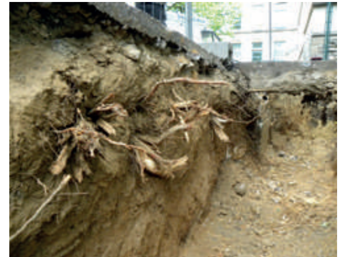
Wurzelschäden einer Baustelle
