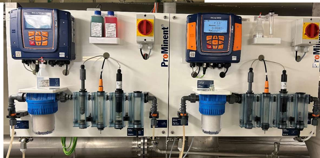
Appareils de mesure en ligne dans la station de pompage Millebaach (Copyright : Ville de Luxembourg)
