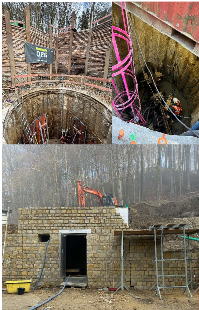
Nouveau captage D01 avec forages horizontaux (Copyright: Ville de Luxembourg)
